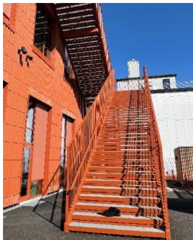
Billede af fordelingstrappe med stejl hældning som ikke vurderes at kunne anvendes til leg og ophold på Nordøstamager Skole
